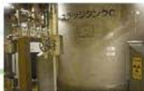
スラッジタンク
